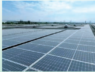
廠區光伏發電設施
